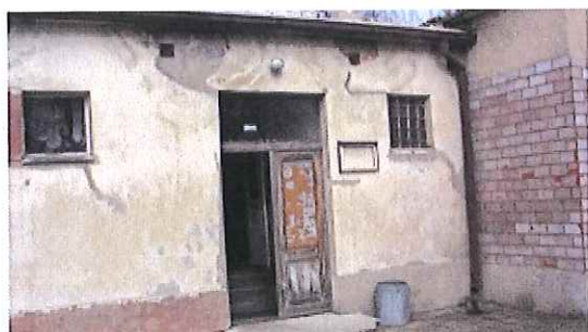
Bud. Nr 4 Wejście ze zniszczoną stolarką Płytki ścienne skorodowane
